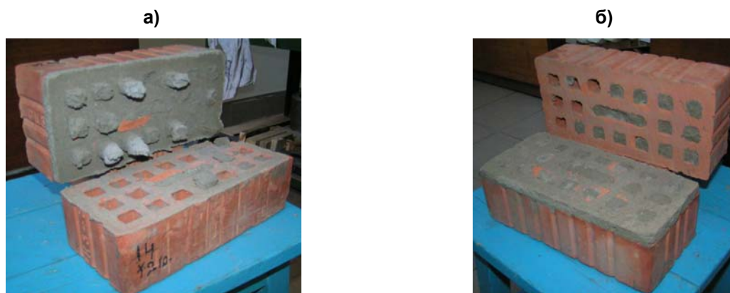
Рисунок 4. Характер разрушения образцов кладки из пустотелого керамического кирпича КРПУ: а – при прочности раствора f_m = 10,9 МПа; б – при прочности раствора f_m = 3,1 МПа
