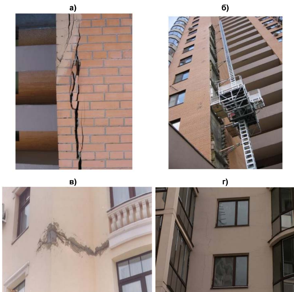
Рисунок 2. Характерные повреждения слоистых стен: а – трещины в облицовочном слое, б – обрушение облицовочного слоя, в, г – трещины в штукатурном слое
